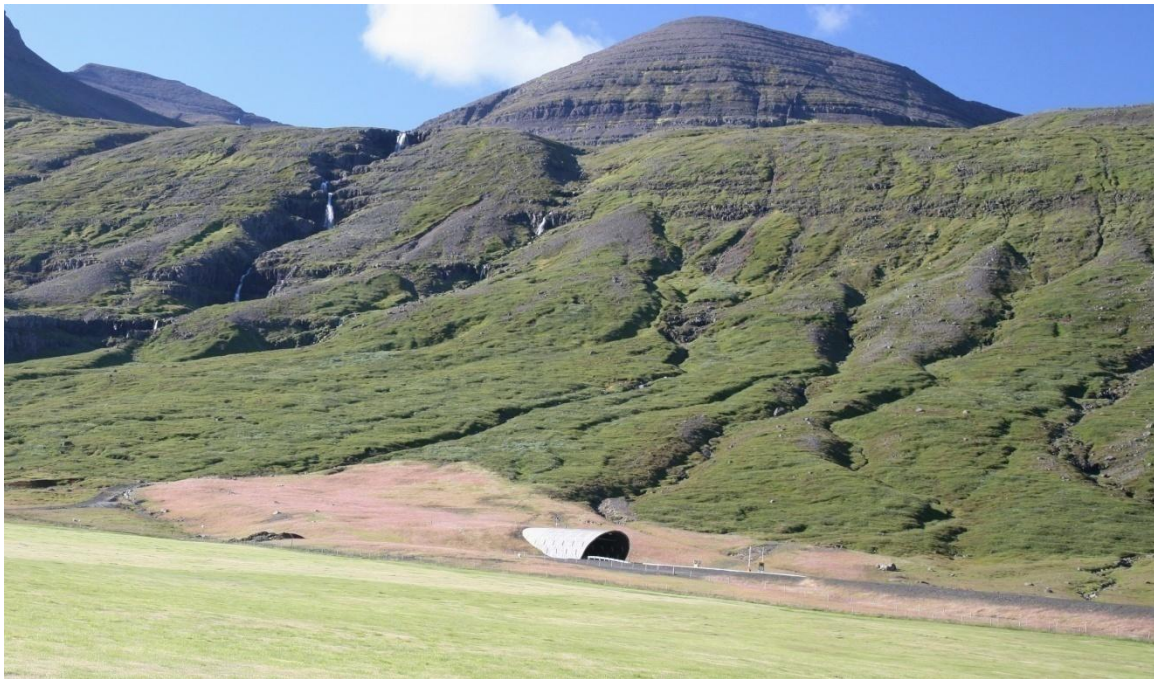
Mynd 11. Séð á hlið gangamunna Fáskrúðsfjarðarganga sem talið er að munninn í Arnarfirði muni líkjast. Mynd Ágúst Guðmundsson.
